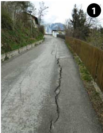
1 Schadenserhebung – Risse in der Fahrbahn ca. 4 bis 5 cm breit
